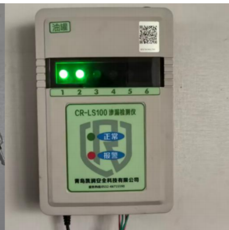
该加油点配备的渗漏检测仪
